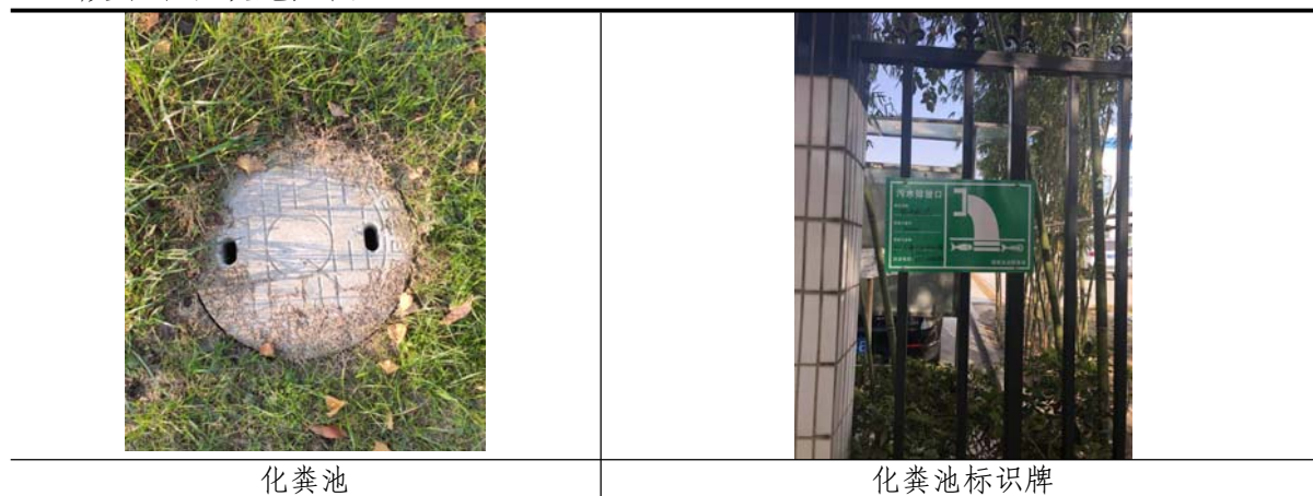
图 4.1-2 废水治理设施图
