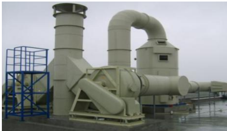
图 5-6 废气处理系统工程实例图
